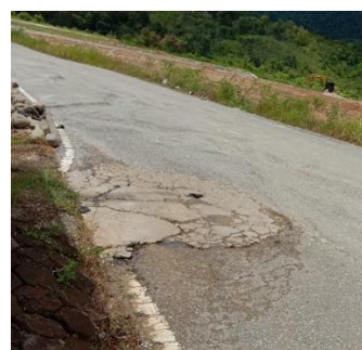
(iii) jalan retak-retak
